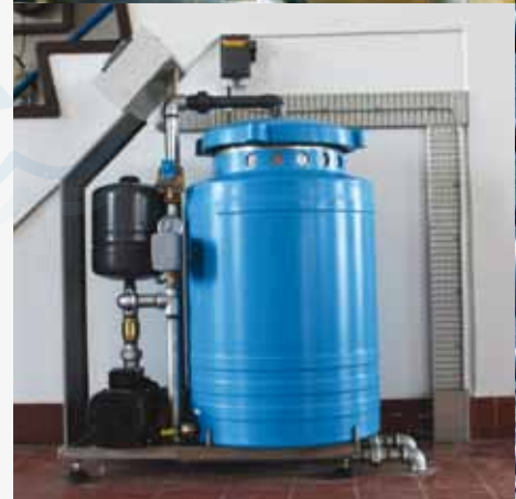
15 anlæg er monteret på Ejby Mølle
